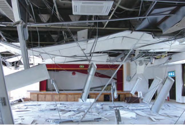
◀震災で天井が崩落した滝根公民館
