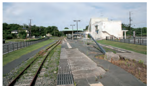
折れ曲がった電柱や変形した線路が残る旧野蒜駅のプラットフォーム
