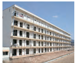
1～4階は津波が突き抜け、ベランダの壁も破壊された「下宿定住促進住宅」
