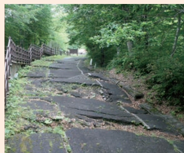
見学通路沿いにある被災した状態のままの旧道
