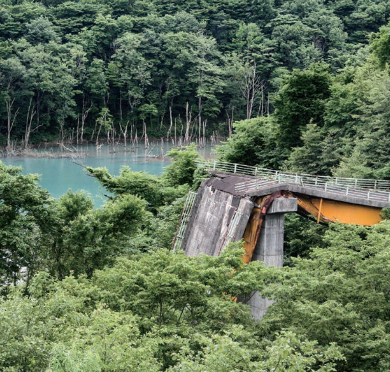
岩手・宮城内陸地震で落橋した旧祭時大橋が今も残る
